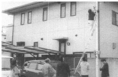
②令和元年11月25日、学童の登下校が多い交差点に向けて防犯カメラを設置しました。
